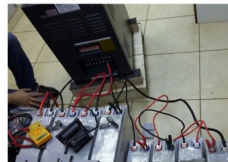
PRUEBA DE INVERSOR
