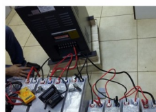
PRUEBA DE INVERSOR
