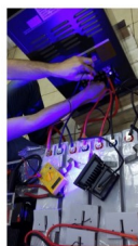
PRUEBA DE INVERSOR
